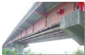
塗膜劣化による錆→放置すると腐食
