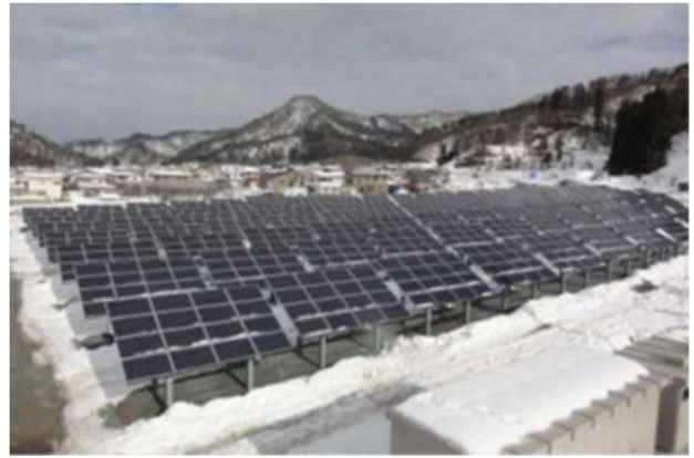
【山形県営太陽光発電所】
