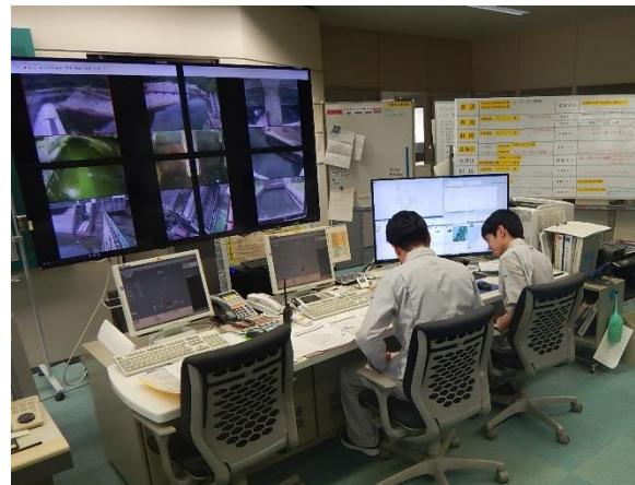
鶴岡電気水道事務所（朝日制御所・監視装置）
