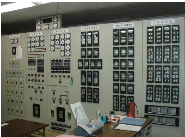
大沢川発電所（配電盤）
