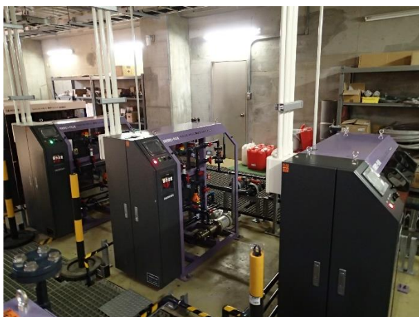
苛性ソーダ注入設備(村山)
