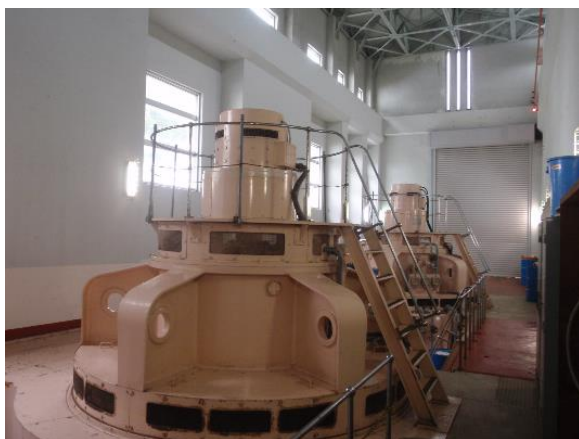
倉沢発電所（発電機室）
