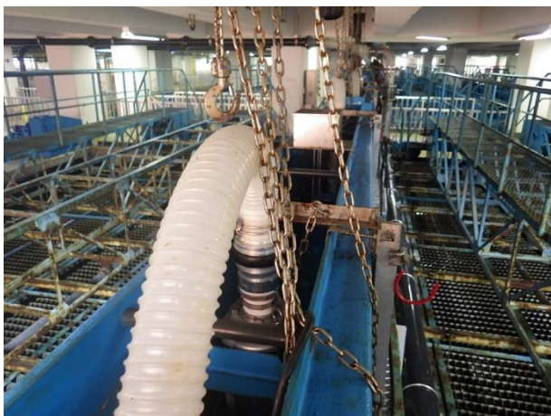
沈殿池中間取出し装置(村山)
