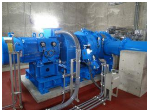
鶴岡量水所小水力発電設備
