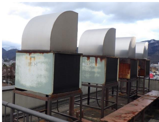
老朽化が進む建物附帯設備
