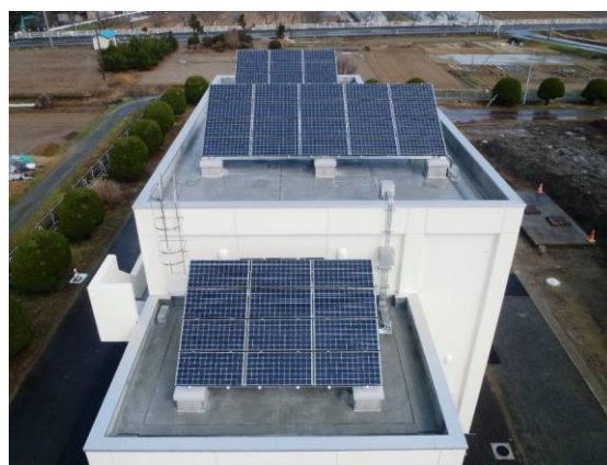
酒田工業用水道遊摺部浄水場太陽光発電設備
