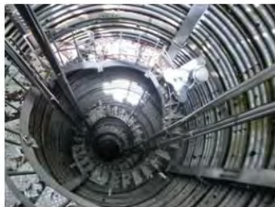
集水井の内部 深さ50m
