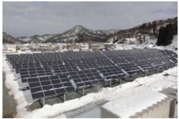
【山形県営太陽光発電所】
