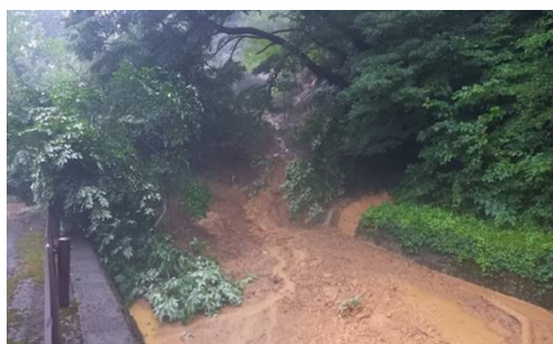
北楯大堰用水路 法面崩落
