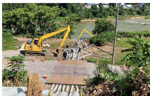
応急ポンプの設置
