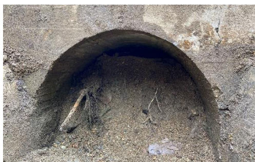
三光堰用水路 トンネル閉塞
