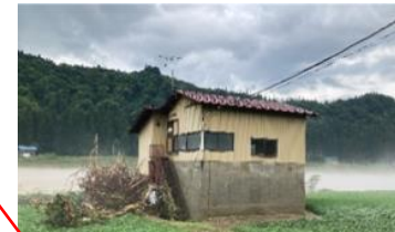
名高第2段揚水機場 浸水(戸沢村 7/26)
