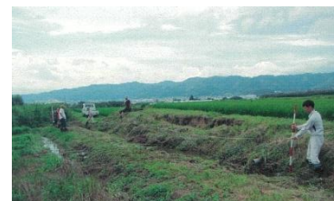
農地 法面崩落(南陽市 7/26)
