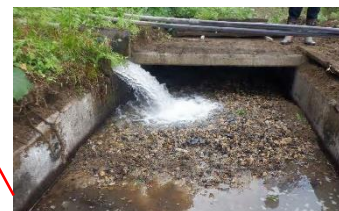
用水路 土砂堆積(長井市 7/26)
