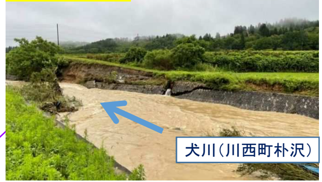
護岸損壊(150m)
