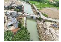
令和6年7月の大雨による荒瀬川の被災状況
