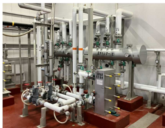
発電によって得られた温水の一部は工場へ供給
