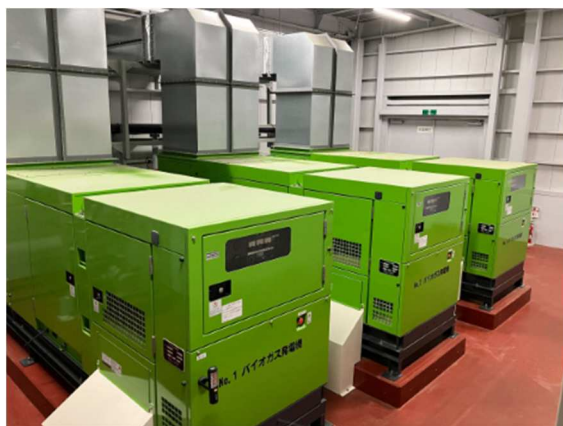
50kw のバイオガス発電機を 3 台設置
