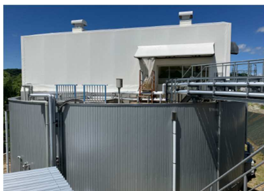
発酵槽（下部 円筒型）で発生したガスを上部のガスバッグ室にて貯留し、発電機へ供給する。
