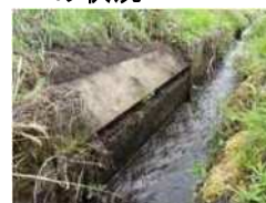
側壁が倒壊した排水路（村山市）
