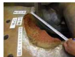
ポンプ内部の摩耗状況
