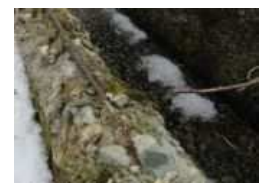
凍害により鉄筋が露出した用水路（庄内町）
