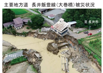
主要地方道 長井飯豊線(大巻橋)被災状況
