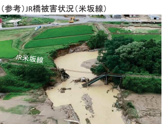
(参考)JR橋被害状況(米坂線)
