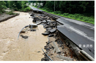
国道121号被害状況
