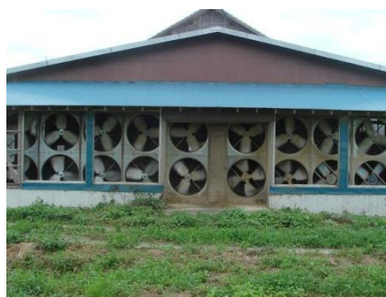
換気扇、送風機の稼働
