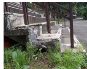
コンクリートの劣化と手摺腐食（林木育種園管理棟入口）
