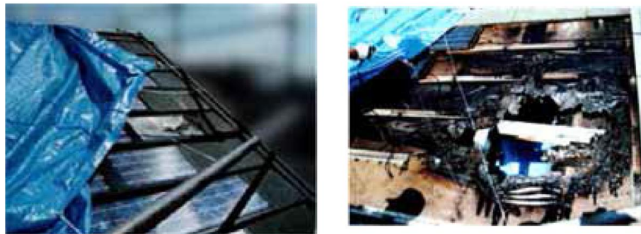
写真4 屋根の被災状況（右はモジュール撤去後）
