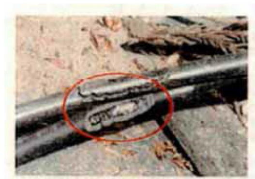
写真 3 小動物が噛んだと思われる ケーブルの損傷箇所
