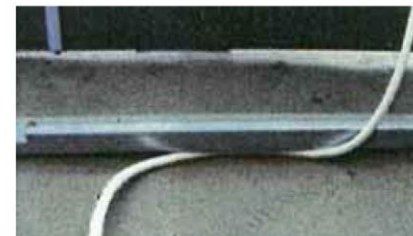
写真5 モジュール固定金具下へのケーブルの挟み込み箇所
