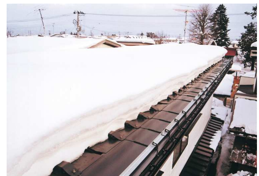
【克雪化の例】 屋根に融雪設備を設置
