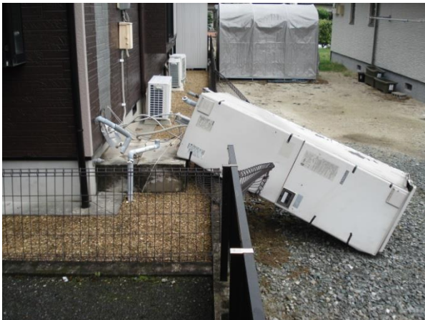
給湯設備被害状況
