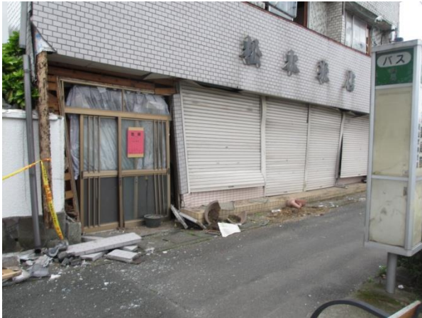
木造建築物被害状況
