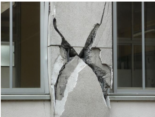
鉄筋コンクリート造建築物被害状況
