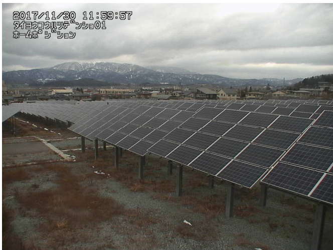
平成29年11月30日 12:00 太陽光発電所の状況
