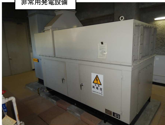
非常用発電設備
