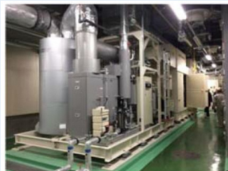
天然ガスコージェネレーションシステム
