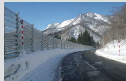
吹き溜り・視程障害対策(吹き止め柵)
