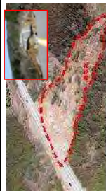
排水不良に起因する法面崩落
