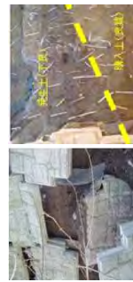
良質土を使用すべき箇所への誤適用(補強土壁)
