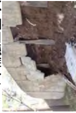
補強土壁の損傷
