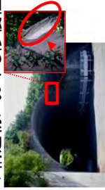
アーチカルバートの損傷
