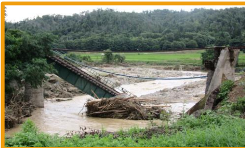
JR米坂線 小白川橋梁崩落(手ノ子駅～羽前椿駅)
