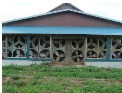
換気扇、送風機の稼働
