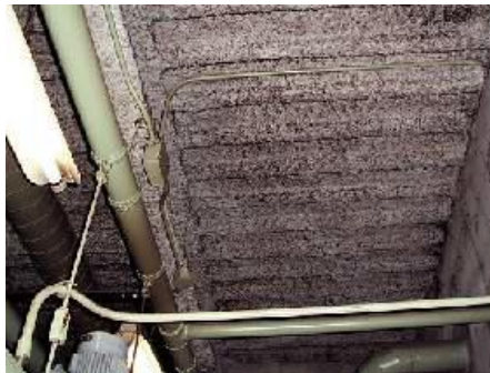
石綿含有吹付けロックウール
