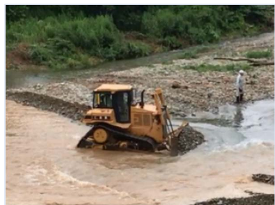
ブルドーザによる河床整正作業 (川底を均し、流下能力の維持を図る)
