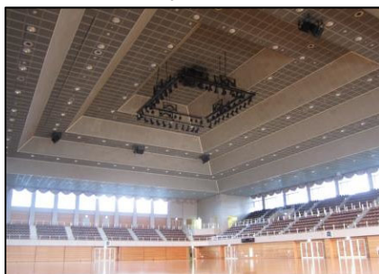
総合運動公園 アリーナ照明設備更新
