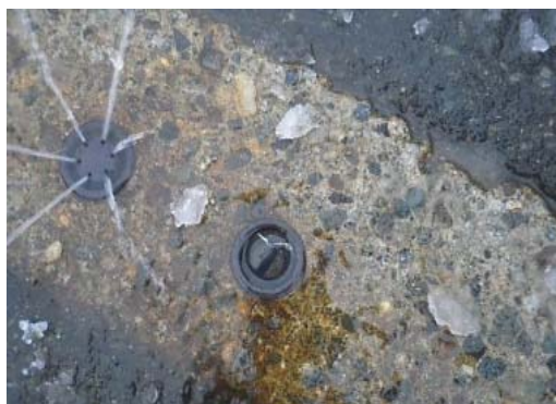
消雪パイプの破損状況
