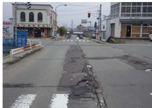
無散水消雪（放熱管）の破損状況
