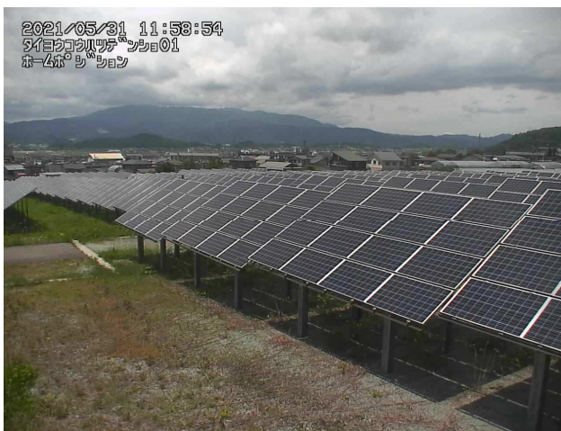
令和3年5月31日 12:00 太陽光発電所の状況
