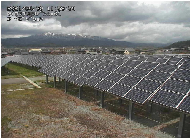
令和3年4月30日 12:00 太陽光発電所の状況
