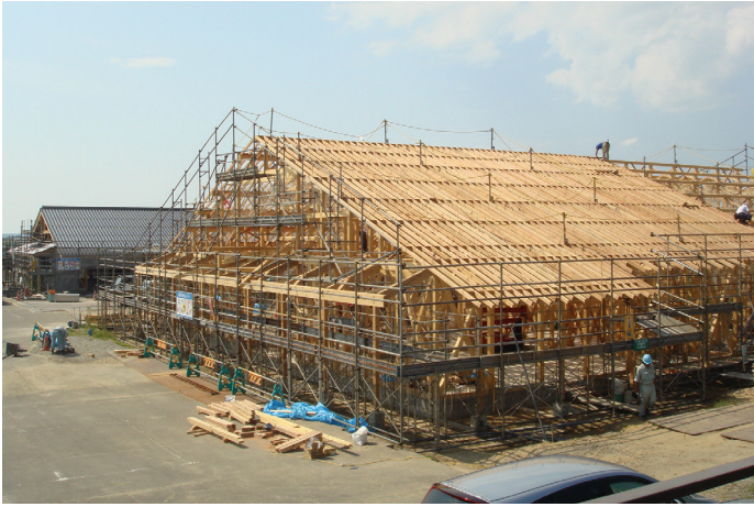
《小屋組状況》屋根は周辺環境へ配慮し、日本瓦による切妻屋根としている
